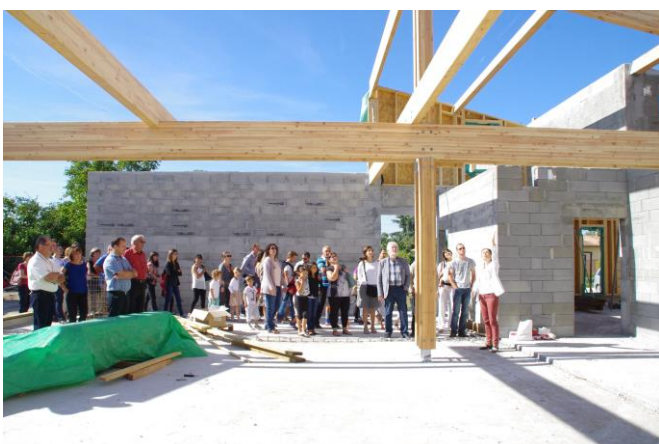
Le futur restaurant scolaire qui, à terme, pourra accueillir également la restauration de l'école maternelle
