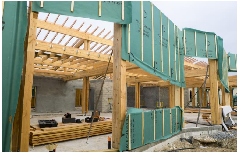
La façade du restaurant scolaire prend forme. avec l'insertion « en pointe » des baies vitrées
